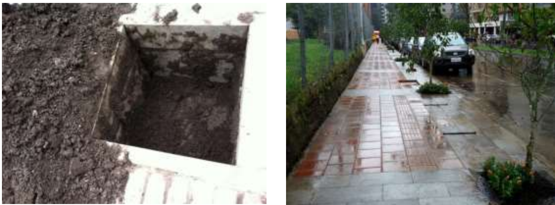
Figura 2. Sistema aplicado en el soterramiento de cables de la Av. República del Salvador en Quito (año 2012). La presa contenedora cuadrangular posee aislamiento de hormigón de 100 cm x 100 cm, dejando la base libre.
